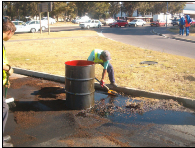
Recogiendo el diesel acumulado al borde del asfalto.
