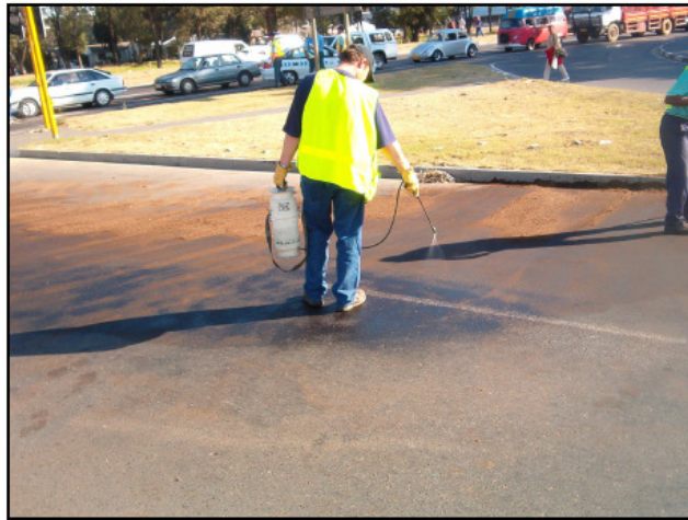
Fumigando con químico sobre la mancha de de diesel que ha quedado.
